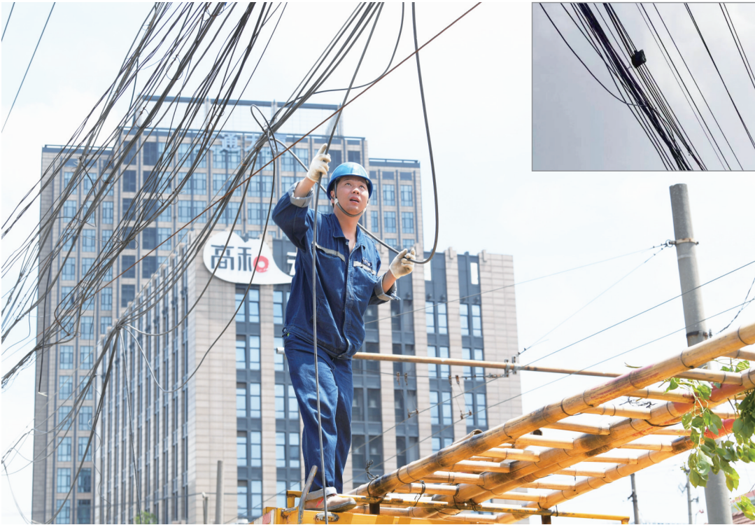
通北路周家嘴路路口,电力公司工作人员正在清除“咬”住架空线的行道树残枝。申城一旦出梅,将进入强对流天气高发、台风影响时段,消除头顶上的“隐患”势在必行。
