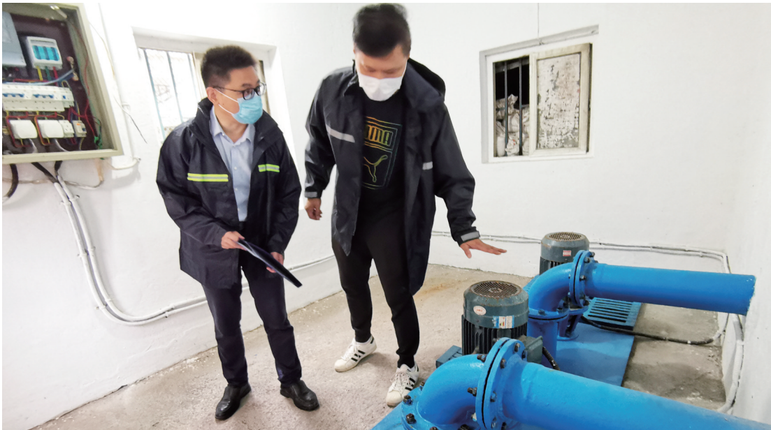
图为社区干部正在巡查防汛泵房。■记者 周琳 摄
