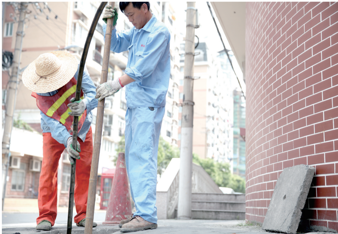
中城连日气温持续攀升,为应对夏季常见的强对流天气,工人们挥汗如雨,抓紧疏通下水道,保障了城市地下管道的畅通。
