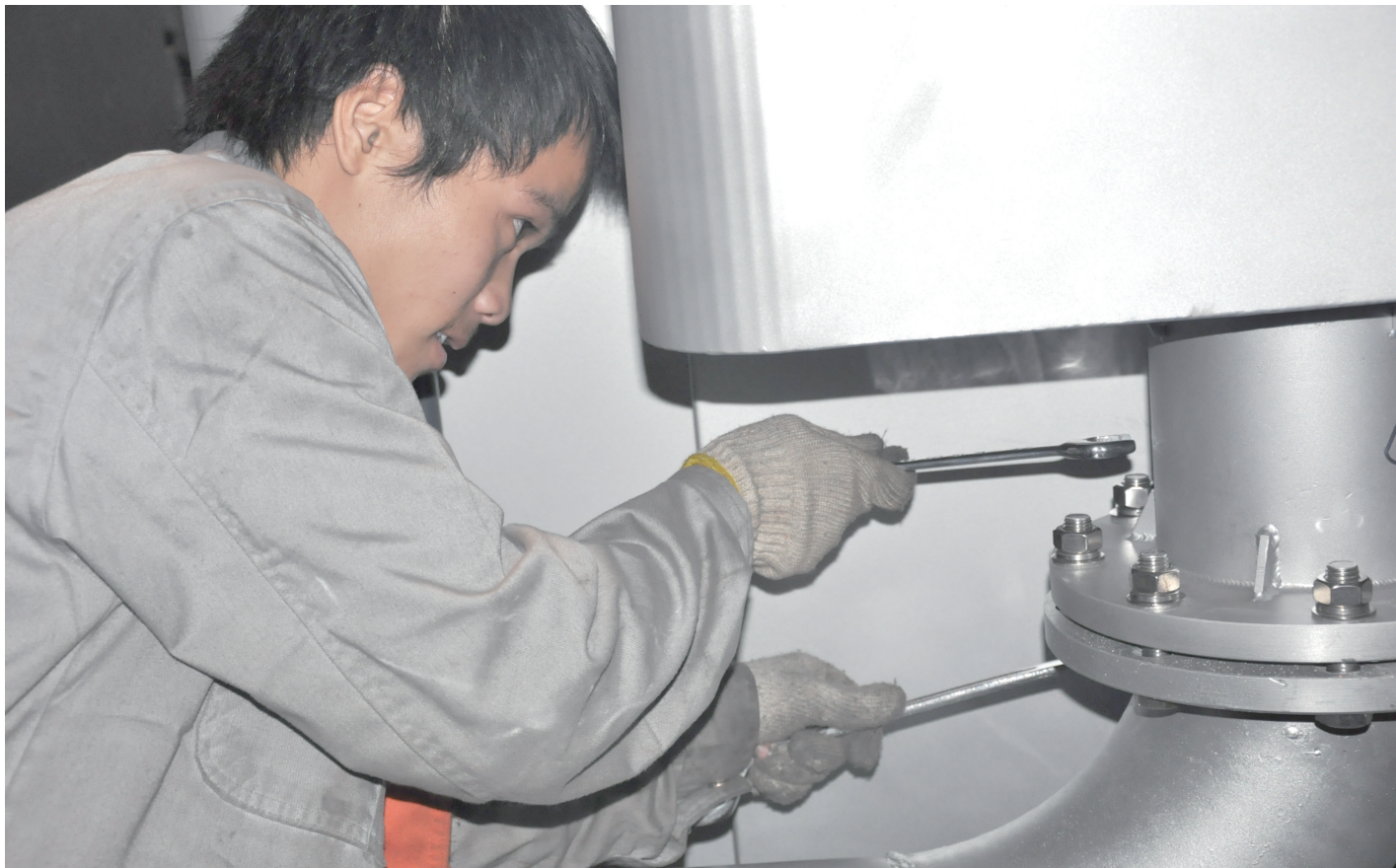
同臣环保嘉定工厂内员工在调试叠螺式污泥脱水机,该设备可广泛用于市政污水处理工程以及石化、轻工、化纤、造纸、制药、皮革等工业行业的水处理系统。
