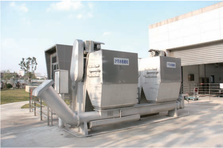
图为明年将投入使用的1号、2号污水格栅机。
