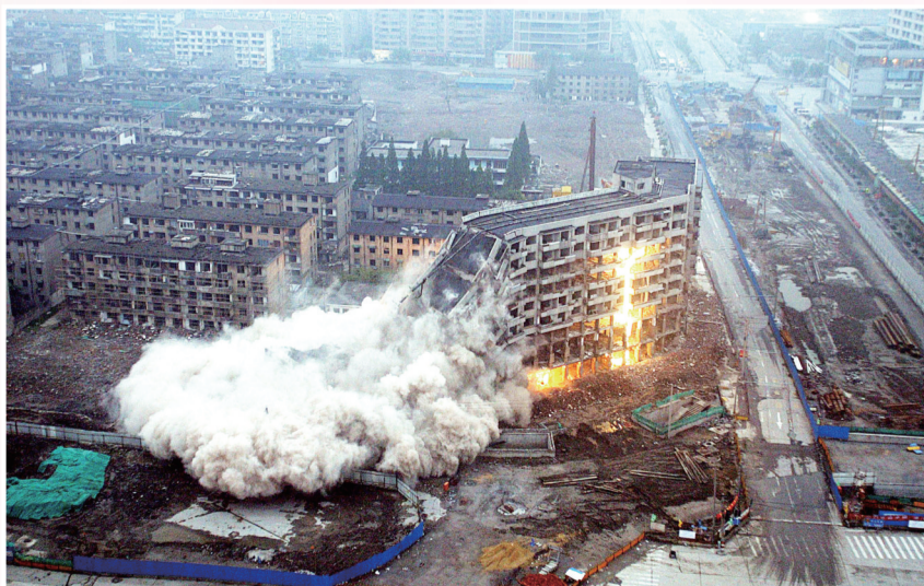
▲五角场改造全面启动,朝阳百货大楼爆破。(2004年7月摄自五角场)
